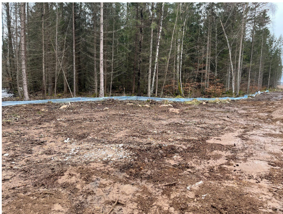
Figur 24. Exempel på barriär i plast vid utbyggnad av väg E22 mellan Lösen-Jämjö i Blekinge. Foto från februari år 2024.
